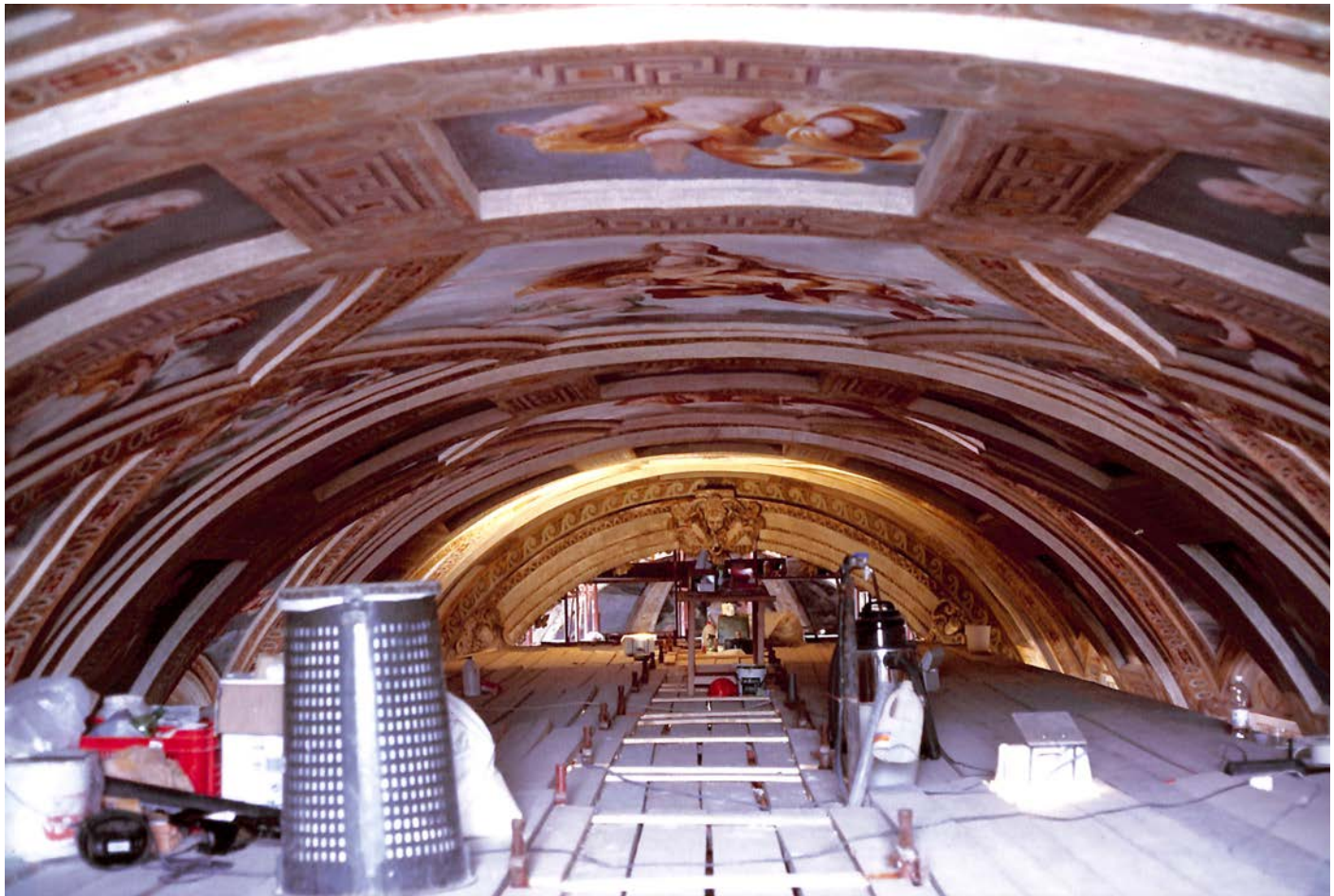
Certosa di Milano, l'intradosso della volta della chiesa ripresa dall'ultimo livello dei ponteggi montati per eseguire i restauri giubilari del 2000.
