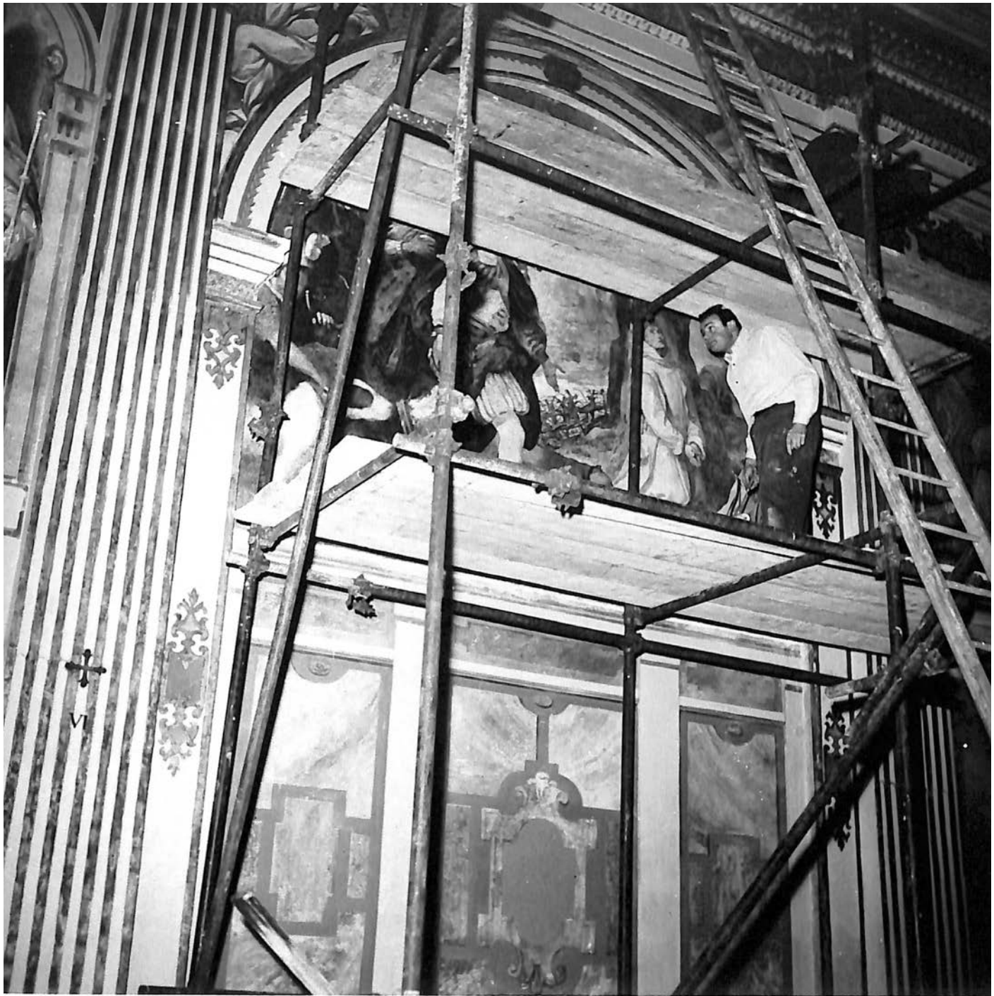
Certosa di Milano, particolare del piccolo cantiere predisposto dal prof. Ottemi della Rotta per eseguire lo strappo e il restauro della pellicola pittorica della VI lunetta raffigurante l'Incontro tra San Bruno e il conte Ruggero di Calabria.
